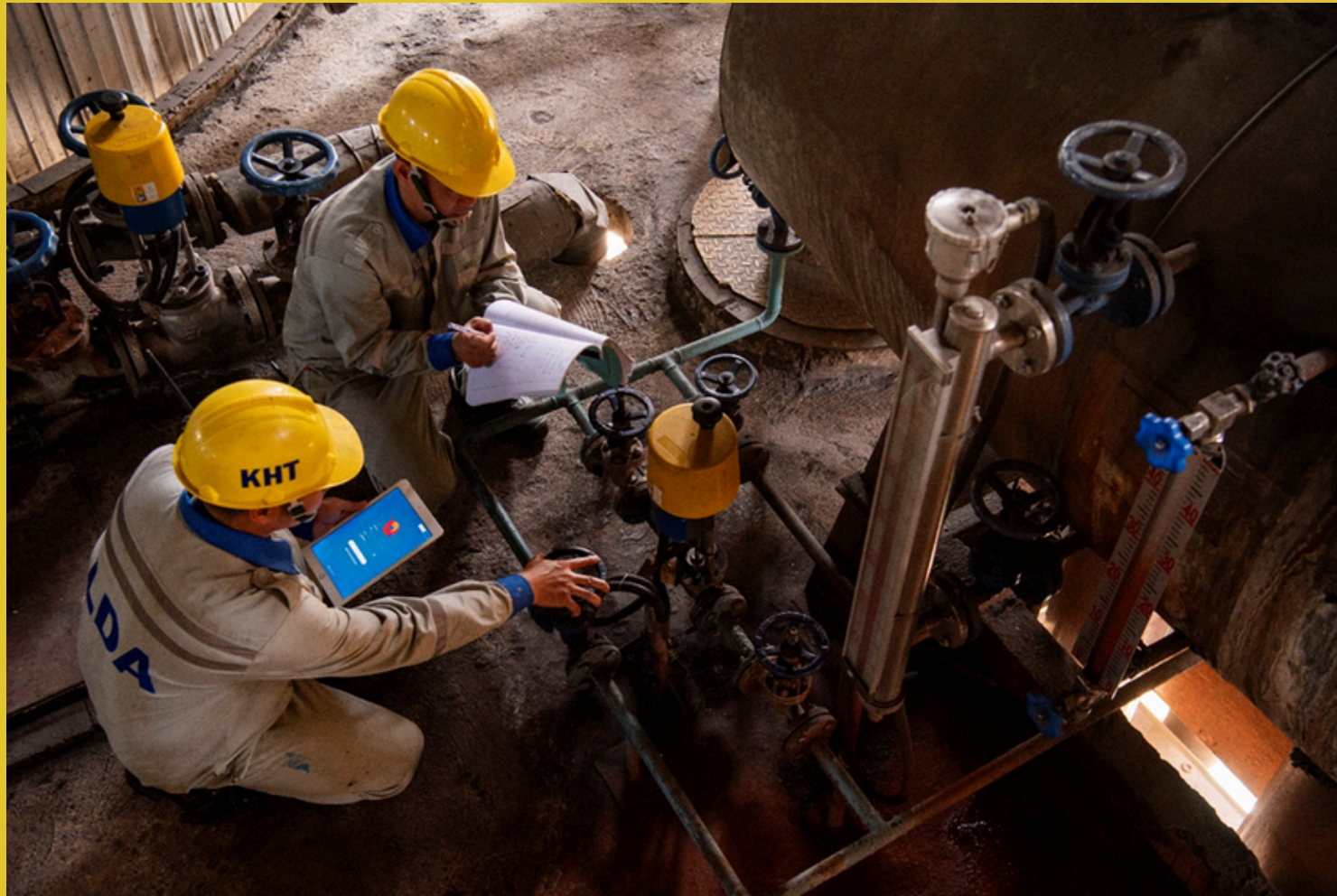
Công nhân Phân xưởng Khí hóa than ứng dụng thiết bị số trong kiểm tra, theo dõi thông số và vận hành hệ thống thiết bị công nghệ
